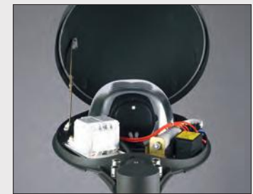
Mantenimiento sin herramientas.
